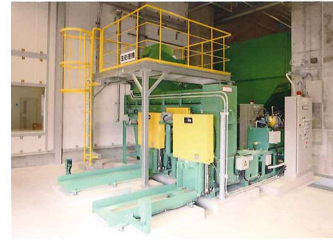
⑨かん圧縮機 搬入されたかん類をスチール缶・アルミ缶に分け、圧縮成型します。
