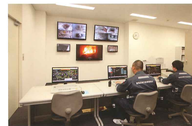
⑬中央制御室 施設全体の処理ラインを管理します。機器の状態や処理の状況をテレビモニタなどで監視し、安全で効率の良い運転を行います。
