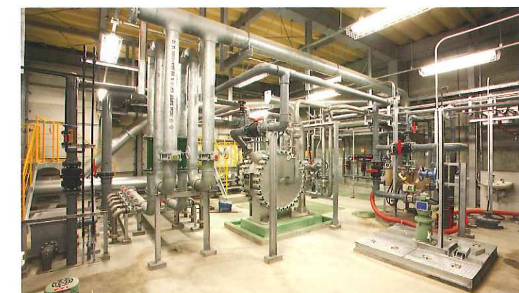
⑫分離水処理設備 メタン発酵槽で発生する汚水を処理し、処理した水を再利用します。
