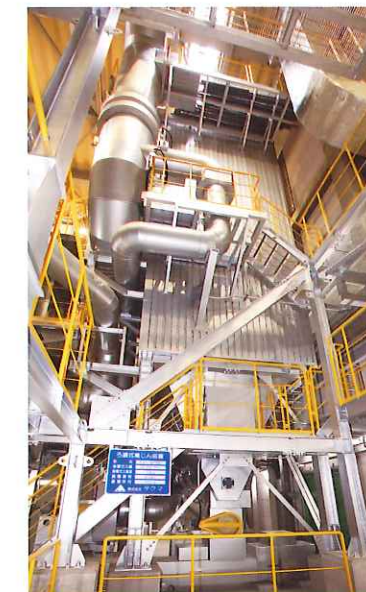
⑩ろ過式集じん装置 排ガス中に含まれる有害ガスを含むダストを捕集します。
