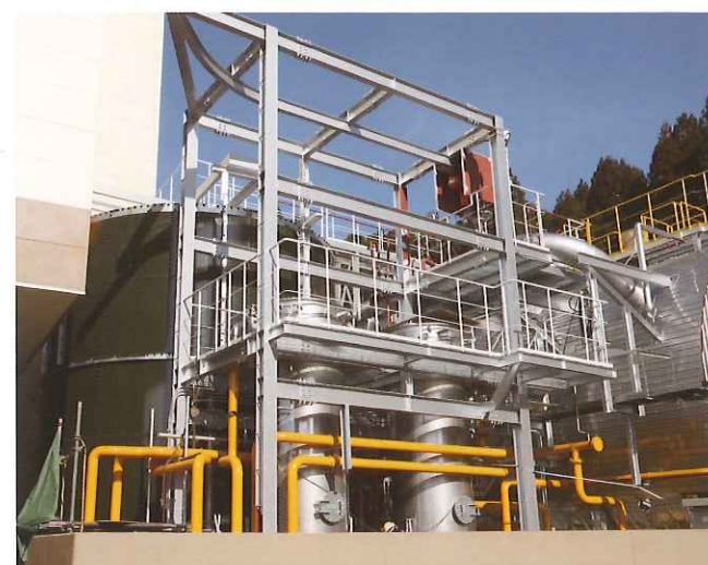
④ガス貯留槽 メタン発酵槽で発生したバイオガスを一時貯留し、ガス発電機へ供給します。
