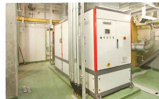
⑥ガス発電機 ガス貯留槽から供給されたバイオガスを燃焼させてガスエンジンを運転し、発電します。
