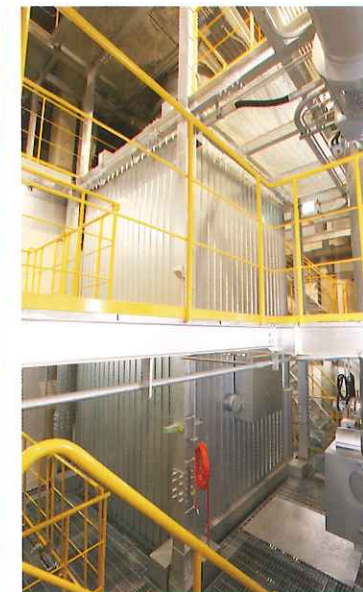
⑪触媒反応装置 排ガス中に含まれるダイオキシン類を触媒の反応で分解します。
