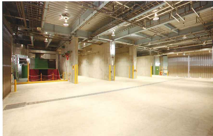
①受入貯留場、受入供給設備 収集車等で搬入した不燃性大型・不燃・資源ごみを貯留し、それぞれの種類ごとの受入ホッパに投入します。
