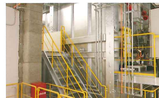
⑦焼却炉 ストーカ式焼却炉で高温で安定した焼却を行います。
