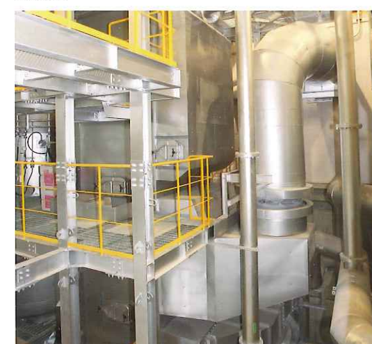
⑨空気加熱器 排ガスより温風を回収し場内で有効利用します。
