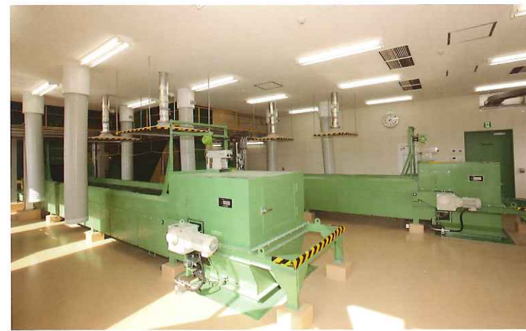
⑥手選別コンベヤ 手選別により、異物を取り除きます。
