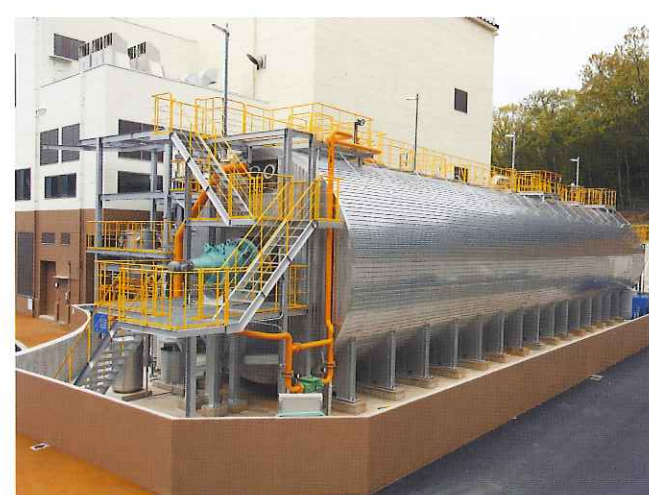
⑤メタン発酵槽 微生物の働きにより、ごみ中の有機物を発酵分解してバイオガス（メタンと二酸化炭素の混合ガス）を発生させます。
