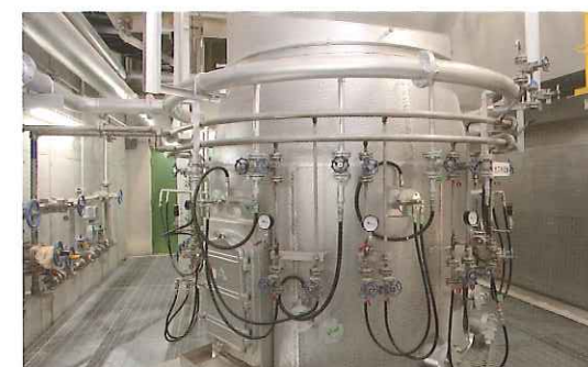
⑧ガス冷却室 高温の排ガスを水噴射により急冷し、ダイオキシン類の再合成を防止します。
