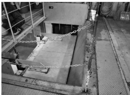
▲高効率原燃料回収施設 粗大ごみ切断機
